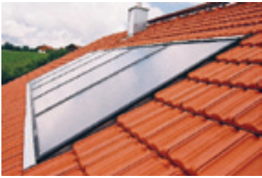
FIGURA 2.2. Os coletores apresentam perfeita integração arquitetônica no telhado, o conjunto está centralizado e instalado abaixo da torre de caixa de água fria.
