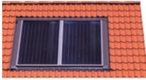
FIGURA 2.3. Os coletores estão inseridos no telhado apoiados na estrutura principal do telhado, possibilitando que fiquem no mesmo alinhamento que as telhas.
