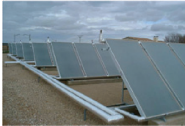
FIGURA 9.23. Instalação com tubulação externa isolada e coberta com alumínio corrugado, fita e presilha.
