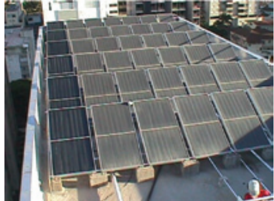
FIGURA 4.10. A lavagem dos vidros é uma das principais manutenções necessárias a de um sistema de aquecimento solar.
