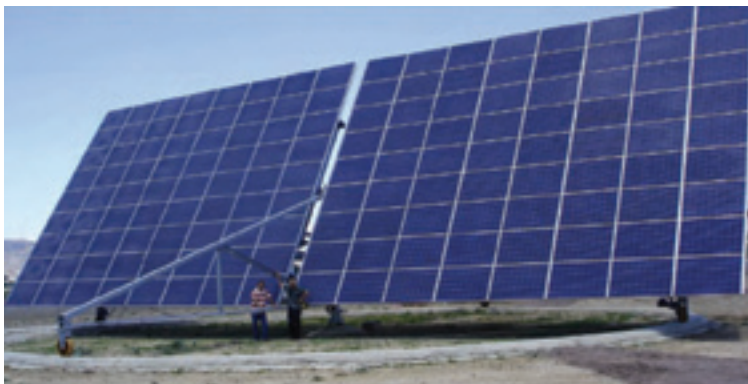
FIGURA 1.20. Associação de painéis fotovoltaicos conectados à rede elétrica. São conhecidos por horta ou fazenda solar, pois ocupam extensas áreas rurais. Seus proprietários vendem a energia gerada à companhia de eletricidade local.
