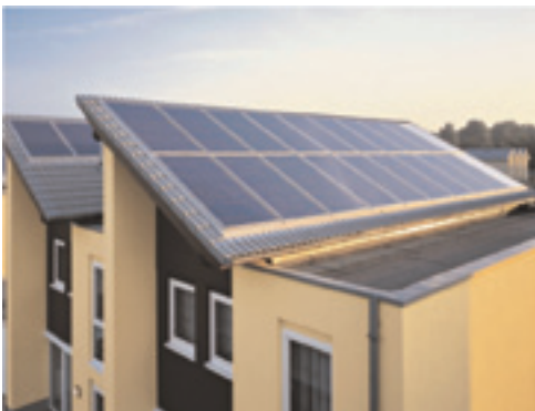
FIGURA 2.31. Os coletores solares estão apoiados sobre o telhado aproveitando sua inclinação.
