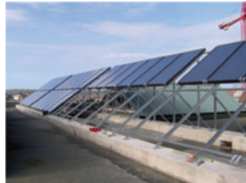
FIGURA 9.11. Estrutura metálica com plano inclinado para suportar duas baterias de coletores solares. Essa configuração é uma solução satisfatória para evitar o sombreamento entre coletores instalados em telhados ou em lajes com espaço reduzido.
