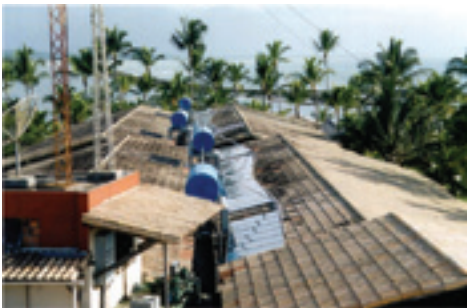
FIGURA 2.18. Hotel em Porto Seguro, Bahia. Aquecedores solares instalados em diferentes posições.
