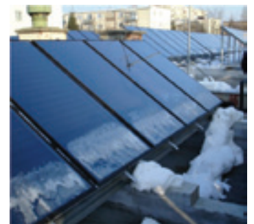
FIGURA 9.25. Os coletores e a tubulação congelará na ausência de sistema anticongelamento.
