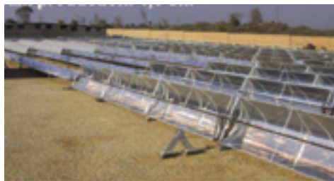
FIGURA 2.24. Fábrica do grupo NASR, Egito. Nessa indústria utilizam-se espelhos parabólicos ao invés de coletores planos.
