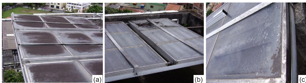
Figura 9.5.5 - a,b,c • Estado dos coletores: (a) sujeira e oxidação, (b) vidros quebrados, (c) infiltração
