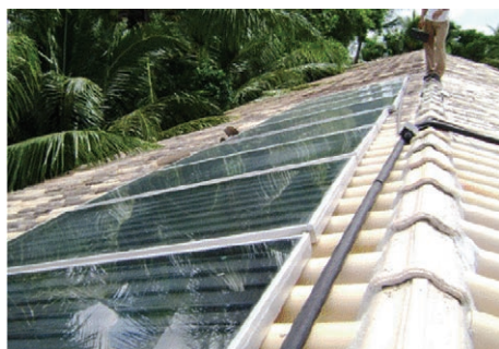
Figura 9.4.5 • Instalações prejudicadas por sombreamento de vegetação
