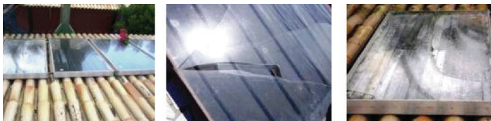
Figura 9.4.6 • Vidros trincados e quebrados nos coletores solares
