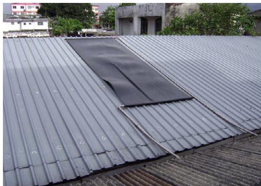
Figura 9.5.4 • Coletor com sombreamento em mais da metade da área coletora
