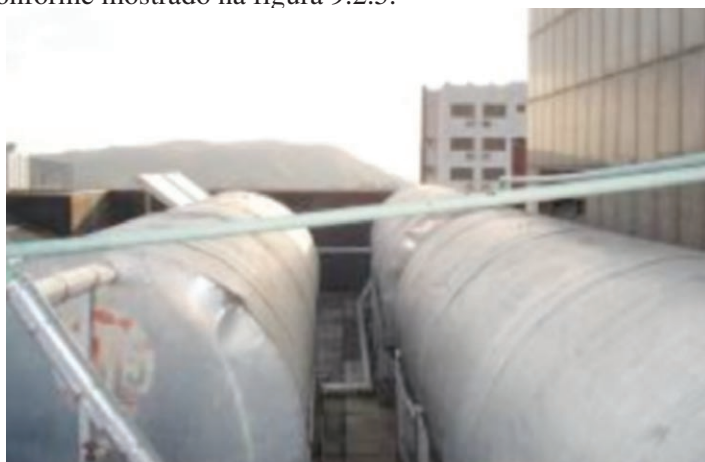
Figura 9.2.5 • Exemplo de trecho de tubulação sem isolamento
