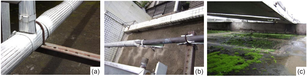
Figura 9.5.6 - abc • Estado da instalação: (a) oxidação dos suportes, (b) falha no isolamento das tubulações, (c) musgo sob os coletores devido a vazamentos
