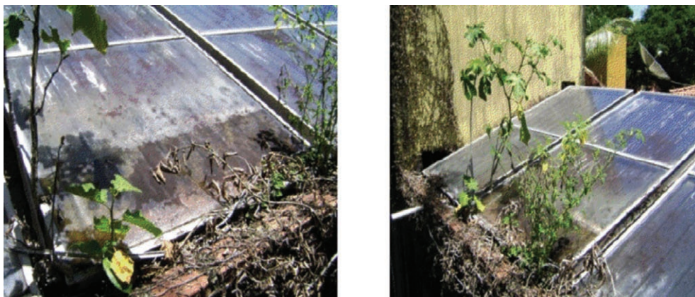
Figura 9.4.7 • Crescimento de vegetação nas placas devido à falta de manutenção
