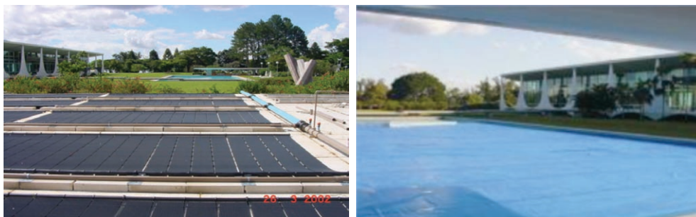
Figura 9.3.4 • Coletor aberto instalado no Palácio do Planalto, Brasília
