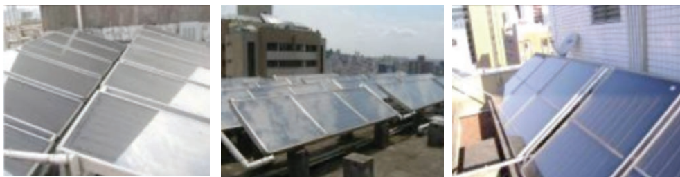
Figura 9.2.4 • Exemplos de inclinações diferentes nos coletores solares pesquisados
