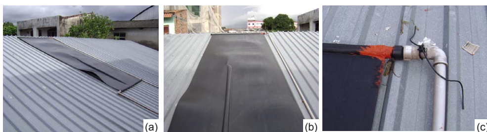
Figura 9.5.9 - a,b,c • Problemas identificados no coletor: (a) e (b) ondulações e formação de uma saliência na superfície do coletor. (c) detalhe do tubo que apresentou vazamento e foi vedado com cola
