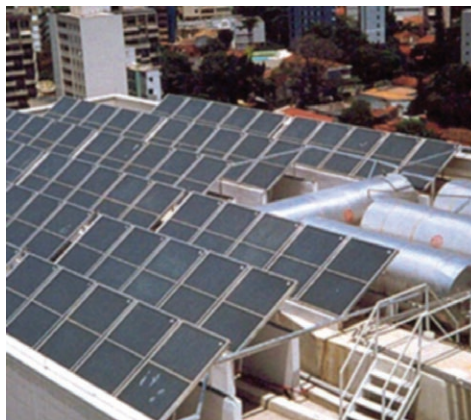
Figura 1.3 • Aplicação do aquecimento solar em hospital em Belo Horizonte
