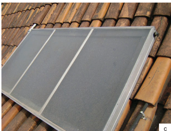
Figura 8.4 - a,b,c • Coletores solares sem limpeza dos vidros de recobrimento, mas ainda em funcionamento em 2011.
